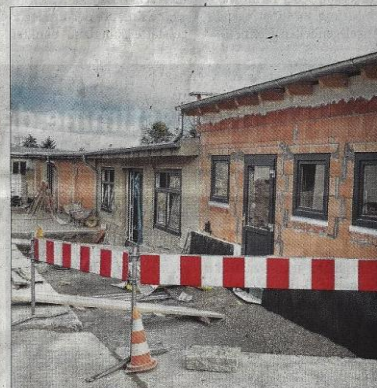
Mehrere Werkstatt-Gebäude am Mönchenfelde werden zu einer Sportanlage mit Sozialtrakt umfunktioniert. Fotos: Jens Müller
