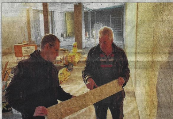
Sven Ungethüm, Vereinsvorsitzender des SV Lok Blankenburg (links), und Bauleiter Peter Bach von der Blankenburger Bau GmbH, auf der Baustelle der künftigen Vier-Bahnen-Anlage am Mönchenfelde.
